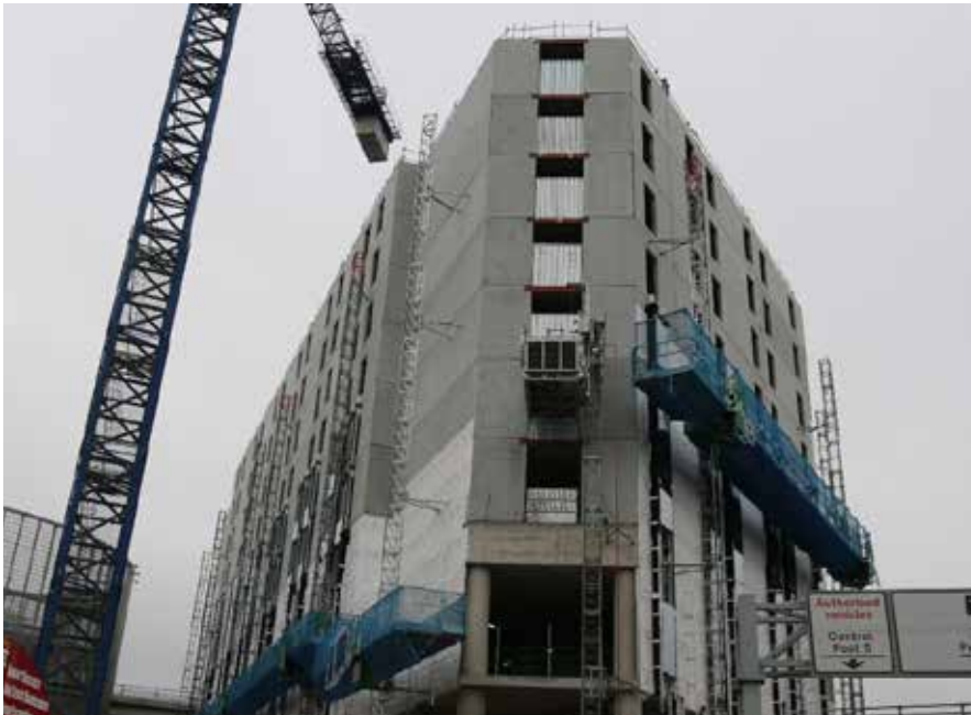
Bild 4: Direkt am Terminal 2 des Heathrow Airport London entstand das Hotel Hilton Garden Inn mit 15 Etagen und einer Gesamthöhe von 47,60 m
