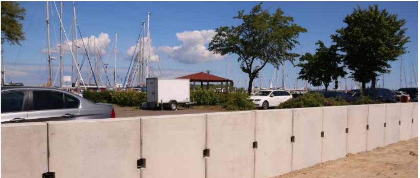
Bild 8: Hochwasserschutzwand mit dem BT-Spannschloss® in Heiligenhafen
