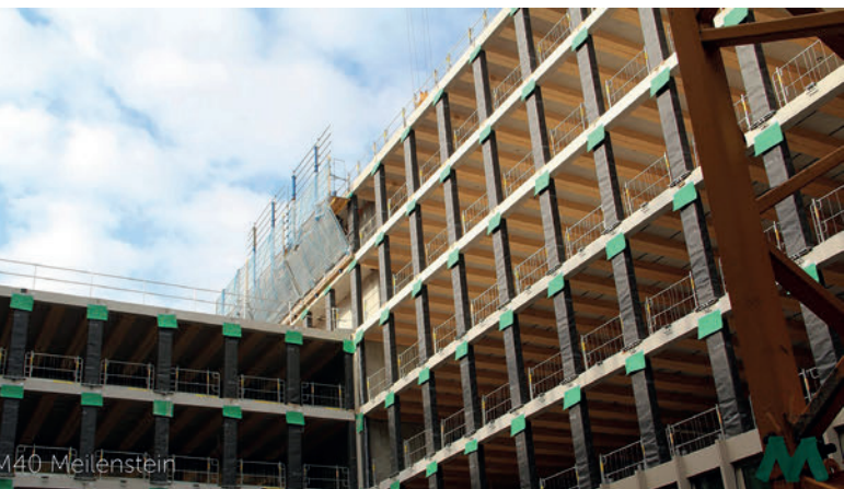
La tour M40 en cours de construction, avec vue sur le dessous des planchers hybrides bois-béton
