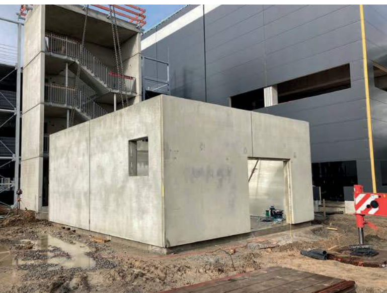
Sprinklerzentrale fertig montiert
