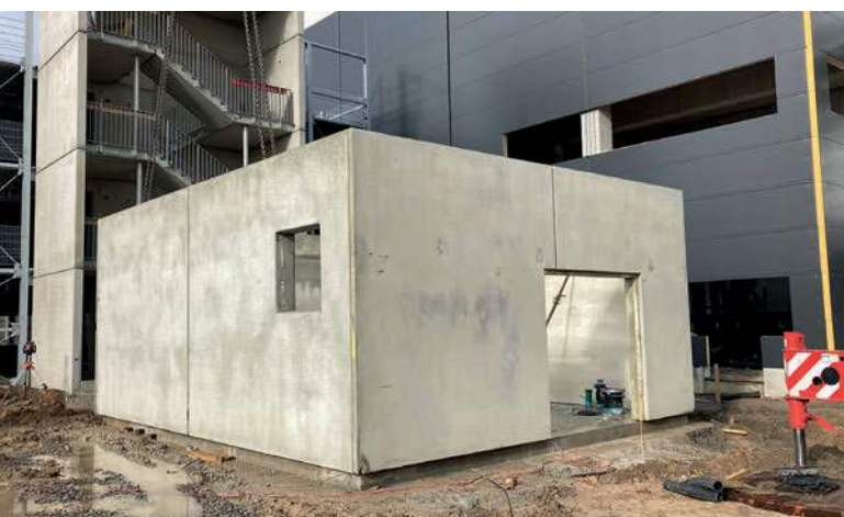
Centrale sprinkler montée
