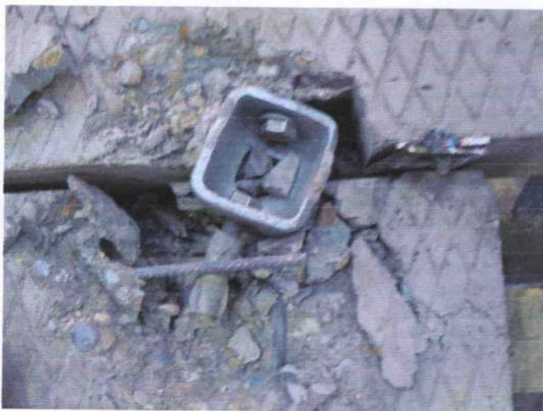
Рис. 4.9 Характер разрушения каждой из 2-х связей в 1-ом опытном образце.
