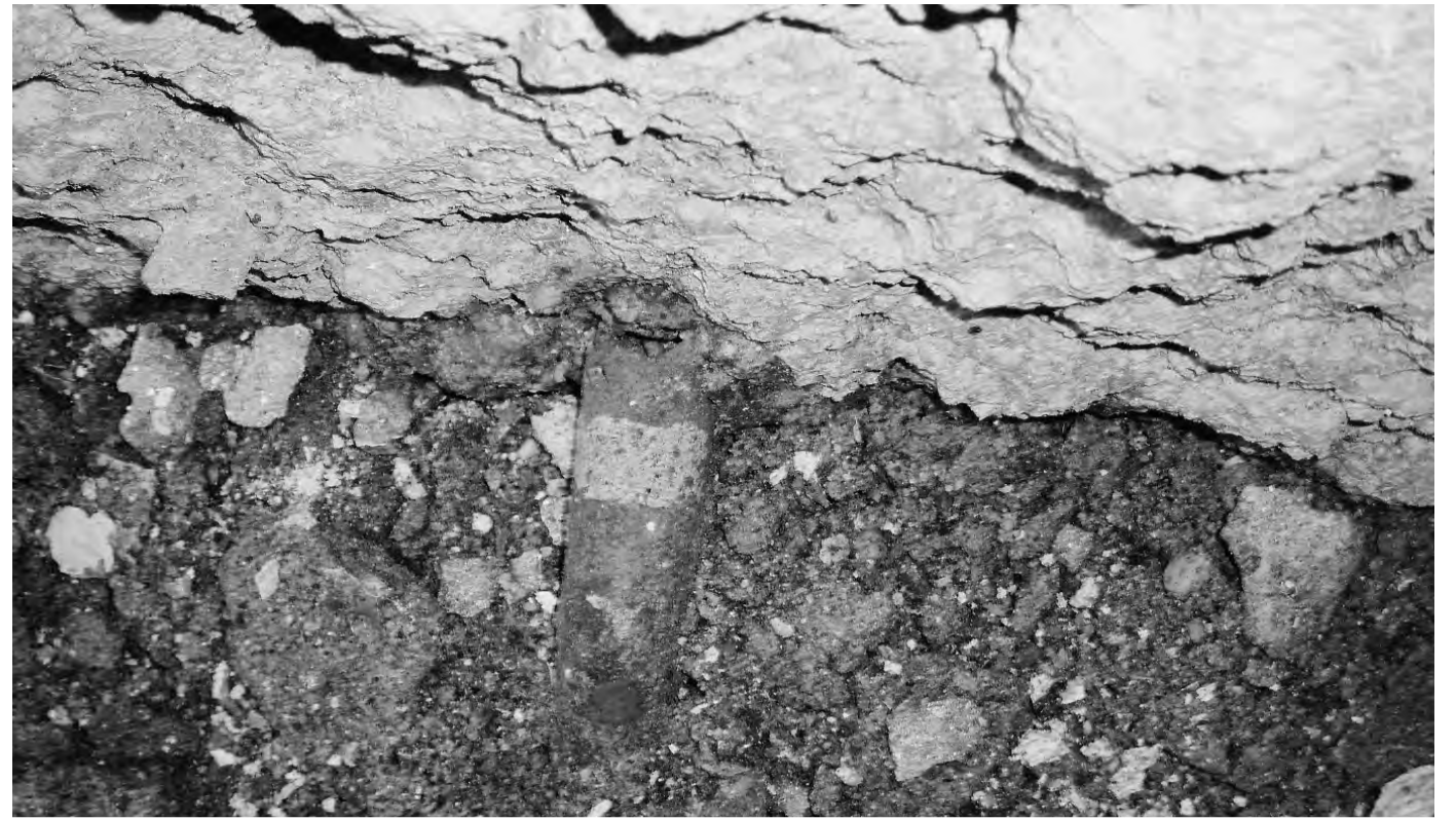
Bilder aus dem Jahr 2007: Biogene Schwefelsäure-Reaktion hatte das Betongefüge des Sandfangs der TWE so stark geschädigt, dass die Standsicherheit der Decke akut gefährdet war. FOTOS: MATTHIAS WITZEL/INGENIEURBÜRO MATTHIAS WITZEL
