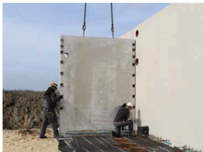
Rapid construction of the biogas plant in Jemgum Der schnelle Aufbau der Biogasanlage in Jemgum
